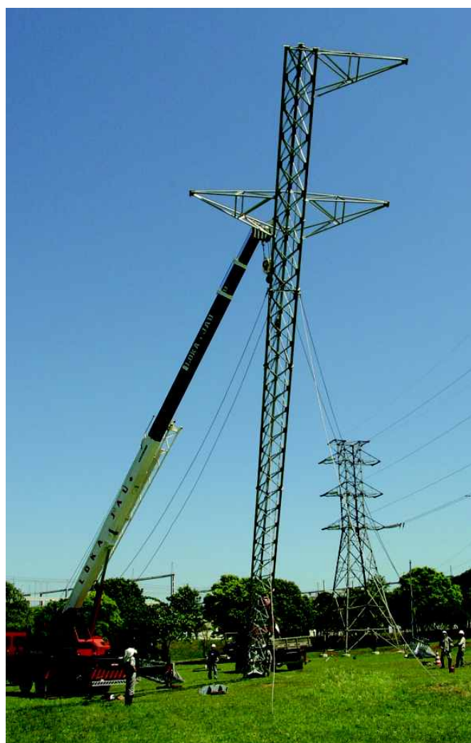
TET alia estrutura esbelta com grande capacidade de carga.
