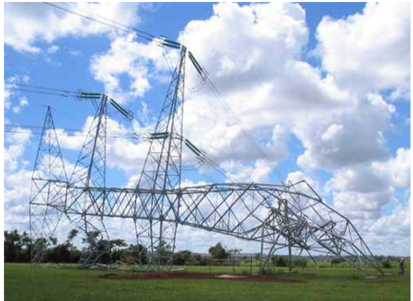
Estrutura convencional avariada.
